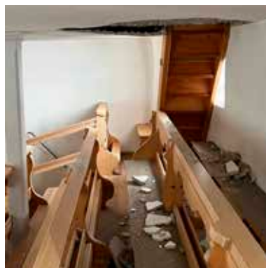
Betreuungsverbot der Empore Pfarrkirche – Wegen herabfallendem Putz musste die Empore vorübergehend gesperrt werden. Die Sanierung ist abgeschlossen.
